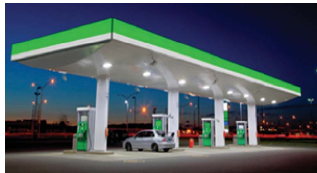
Πρατήριο ανεφοδιασμού LNG
